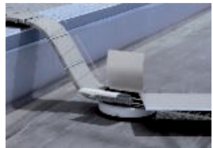
Alkalmazás tűzterjedési gátat keresztelő vezetéseken
